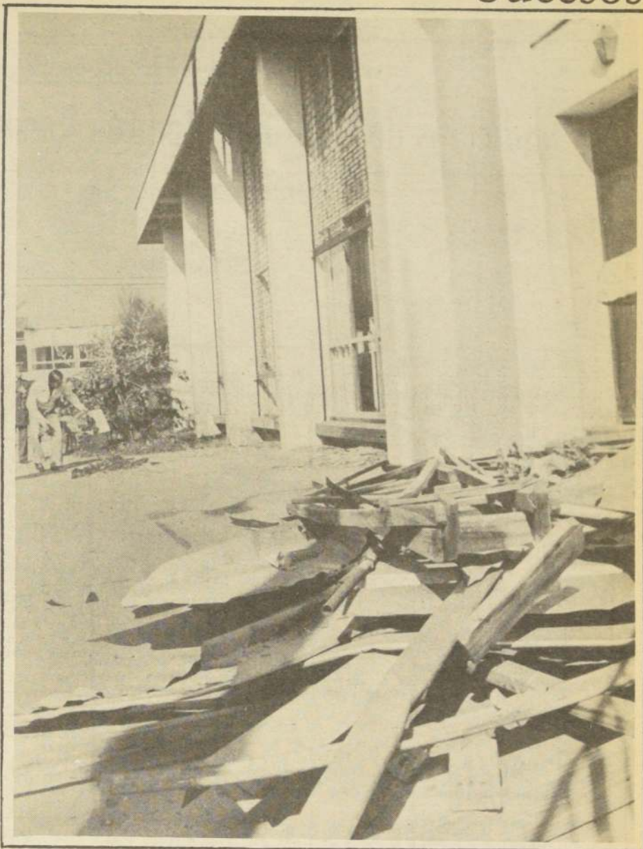
LA BOMBA que estalló en la sucursal del Banco de Crédito e Inversiones provocó destrozos en el techo del recinto, un forado en el cielo raso y la quebrazón de los vidrios. De la parte inferior del alero cuelga uno de los cables activadores del artefacto.
