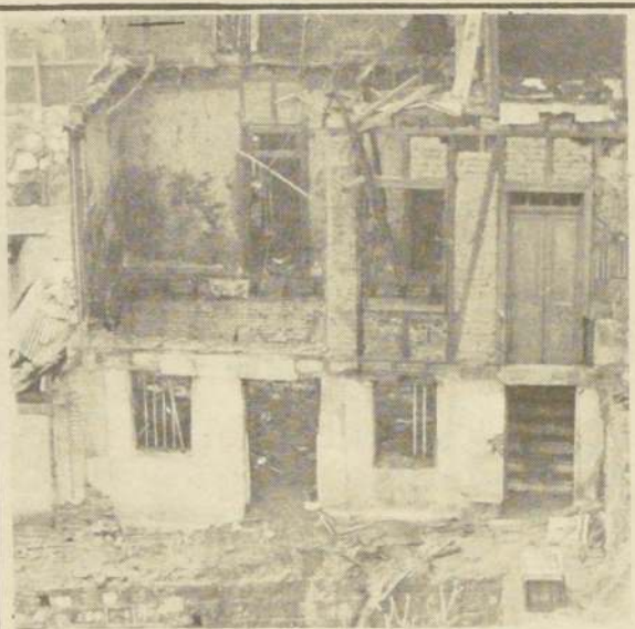
Cuatro personas de una familia murieron carbonizadas en el incendio que destruyó esta casa de tres pisos, en el Cerro Barón.
