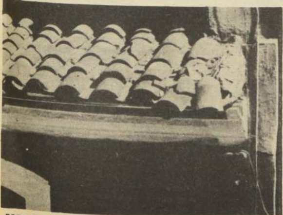
FOTO D. El peligro acecha en calle Merced. Las tejas pueden caer de un momento a otro. Tenga cuidado al pasar por donde está ubicada esta reliquia colonial.
