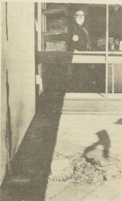
Juan Giacaman muestra el lugar donde fue colocada la bomba que estalló a las 23.30 horas del viernes, en su local comercial ubicado en Apoquindo con Manquehue. Resultaron quebrados todos los vidrios y parte del piso donde está colocado el medidor del agua, daño que se observa claramente.
