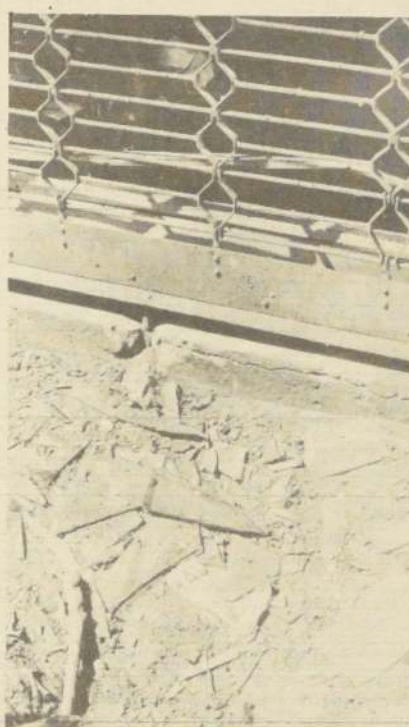
En la Sucursal del Banco de Crédito e Inversiones, ubicada en Américo Vespucio, estalló una de las primeras bombas la noche del viernes ocasionando daños de consideración, tal como se aprecia en la fotografía.
