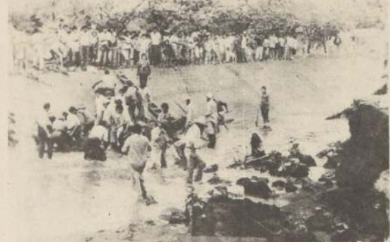
Trabajadores nicaragüenses levantan parte del puente Edén, que se derrumbó a causa de las intensas lluvias que han afectado al país y que se dejan sentir también en vastas zonas de Honduras. (Radiofoto AP).
