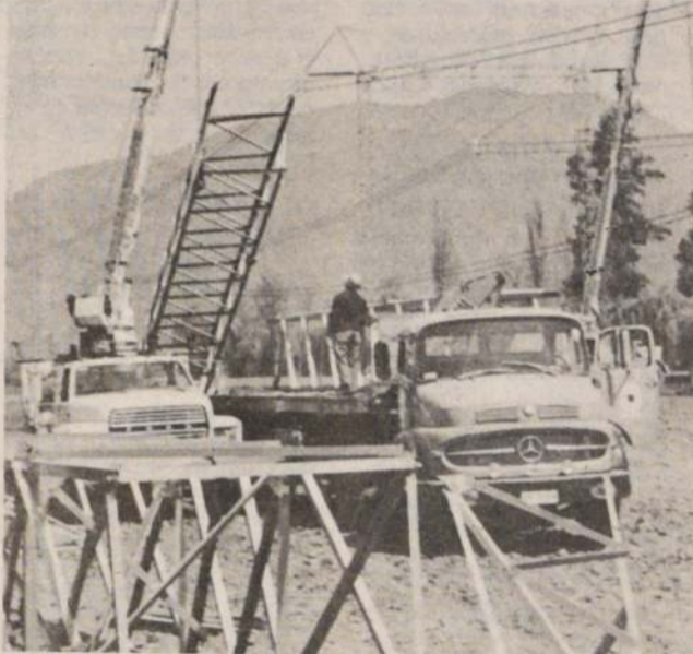
Durante la mañana de ayer quedó totalmente normalizado el suministro de energía eléctrica luego que cuadrillas de Endesa repusieron la torre de alta tensión 523 de Graneros, derribada por un artefacto terrorista.
