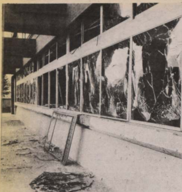
Con prácticamente todos los vidrios destruidos resultó la sucursal del Banco del Estado que se encuentra en el paradero 11 de la Gran Avenida, luego de que antisociales hicieran estallar un artefacto explosivo en el lugar.
