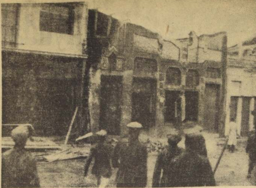
DEMOLICIÓN EN LOS ANGELES.— De 508 casas que fueron revalidadas en el centro comercial de Los Angeles, la Municipalidad ordenó demoler 215, por ofrecer inminente peligro para la vida de los habitantes. En general, la proporción de demoliciones llegará al 70% de las casas de esa ciudad. En el grabado aparece una casa de alto, de calle Colón, entre las de Lautaro y Colo Colo, que es derribada por obreros municipales y soldados del Regimiento Andino.
