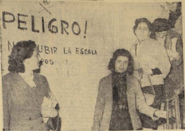
Algunas alumnas de la Universidad Técnica del Estado en los momentos en que descienden por una de las escalas del interior del deteriorado edificio. En el muro, claramente,
