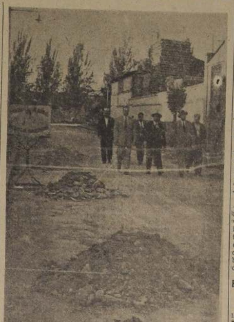
Regidor don Luis Ugarte y miembros de la Junta de Vecinos de la calle Santiago Concha, verifican, junto con un representante de LA NACION, el estado de dicha vía recién pavimentada, pero que está cubierta de montones de escombros.—La Dirección de Pavimentación debe hacerlos retirar para evitar accidentes.
