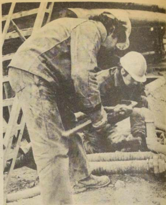
EL FRÍO aprieta y sobre las cañerías y llaves escar-chadas, se trabaja arduamente para que el petróleo siga fluyendo y entregando divisas al país.
