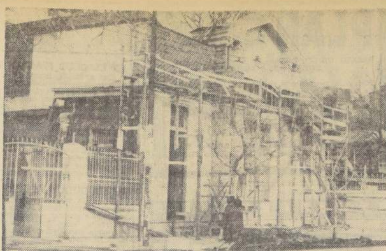
VALPARAISO.— REPARACIONES EN EL LICEO EDUARDO DE LA BARRA.— Se efectúan actualmente reparaciones en el Liceo de Hombres "Eduardo de la Barra" de este puerto, las que se hallan suficientemente avanzadas. El local del Liceo, que se encuentra bastante deteriorado por el tiempo, sufrió diversos daños con el sismo del 28 de marzo. En el grabado, la fachada del tradicional liceo porteño, por el que han pasado tantas ilustres figuras de nuestra ciudad y del país.
