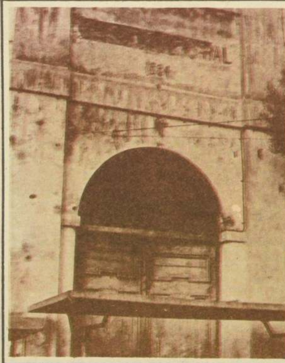
MERCADO CENTRAL: Fachada poniente necesita algo más que pintura
