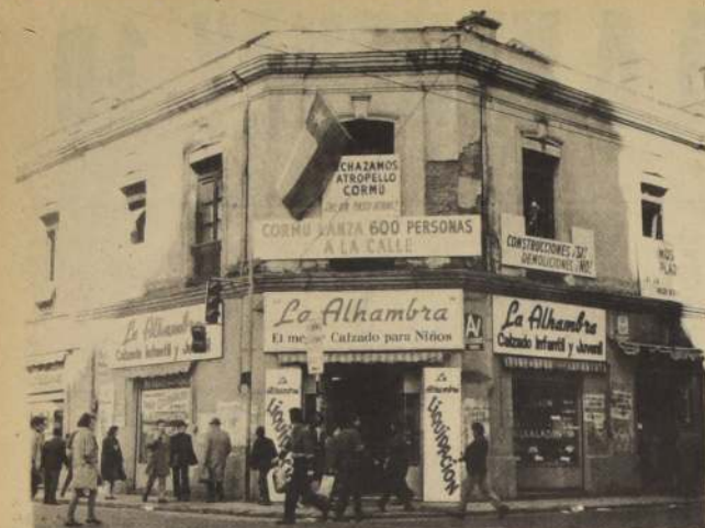
Este edificio, cuyo mal estado puede apreciarse en la fotografía, impide la construcción de un moderno conjunto arquitectónico de 19 pisos, que además de ser solución habitacional para muchas personas, permitirá el ensanche de las calles Monjitas y San Antonio.
