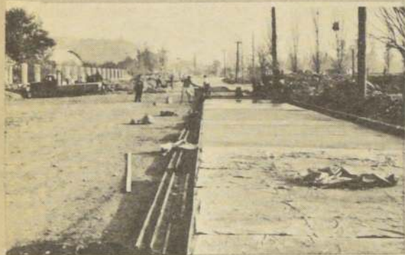
SE OLVIDARON de la otra mitad de la calle Fleming, en Colón 8.000.
