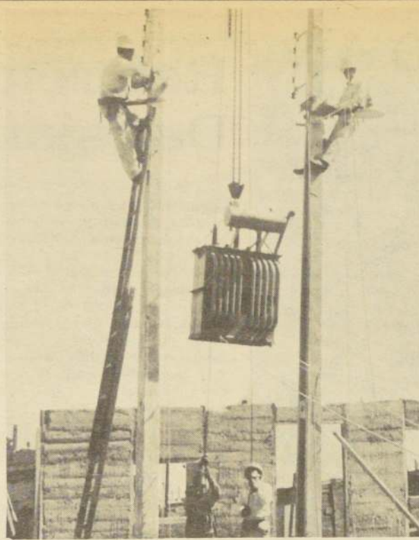
LA COLOCACION de un transformador en el Barrio Alto acarrió la destrucción de un hermoso y bien cuidado bandejón de pasto.
