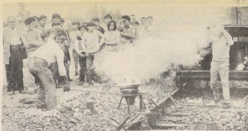
Cuadrillas de trabajadores de FF.CC. del E repararon, en la mañana de ayer, la línea férrea al sur que fue destruida por una bomba colocada por desconocidos, a la altura del paradero 20 de Ochagavía, frente a calle Fernández Albano con Avenida La Feria, en San Miguel.
