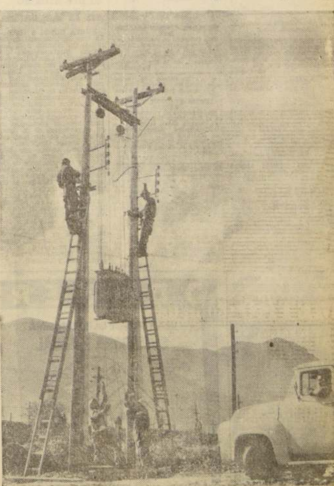
Desde el 1.º de julio, la Compañía Chilena de Electricidad se ha hecho cargo de la distribución de energía eléctrica para la ciudad de May-Lay. Con este objeto, CHILECTRA ha efectuado numerosas mejoras en las redes y colocado nuevos transformadores de distribución con el fin de proporcionar un mejor servicio a tan importante zona. En el grabado, vemos a operarios técnicos de CHILECTRA en las faenas de instalación de uno de esos transformadores.
