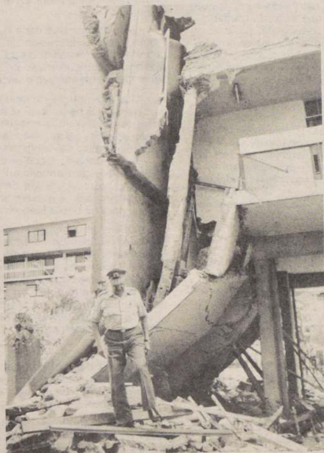
El intendente Metropolitano, mayor general Osvaldo Hernández Pedreros, verifica los destrozos en el block N° 72 de la Villa Olímpica.
