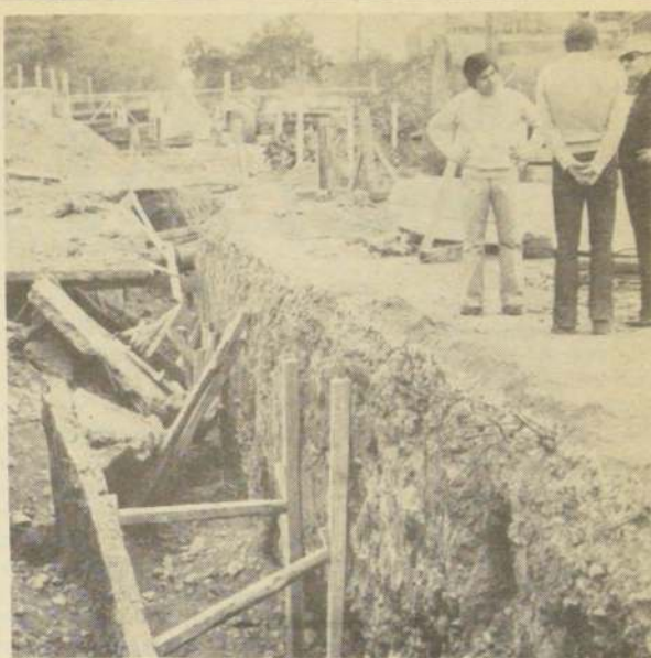
En el mismo lugar del accidente "El Cronista" conversa con los dos ingenieros a cargo de la obra. La foto es elocuente y muestra la gravedad del derrumbe que dejó varios trabajadores lesionados, uno de ellos de consideración.
