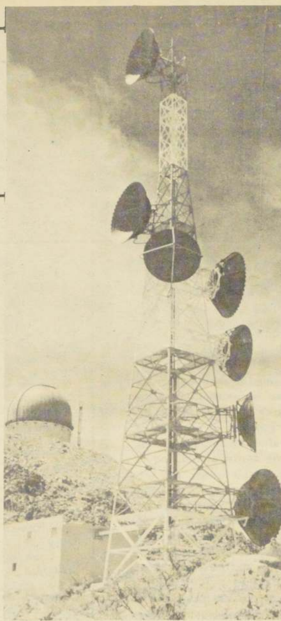
RADIOESTACION repetidora de la red nacional de telecomunicaciones, ubicada en Cerro Tololo (IV Región) cerca del Observatorio Astronómico. Este tipo de antenas está considerado como emisoras de micro-ondas.
