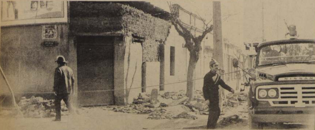
EN LA CALLE, vivienda número 1300, esta casa debió ser evacuada por sus moradores. Los bomberos colaboraron en el despeje de los escombros y en procura de evitar su derumbe total.
