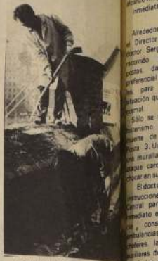
EN LA PARTE superior del cerro de Playa Ancha, hubo necesidad de realizar trabajos de rescate y constituir un pelotón de agrietaduras exteriores y cornisas.
