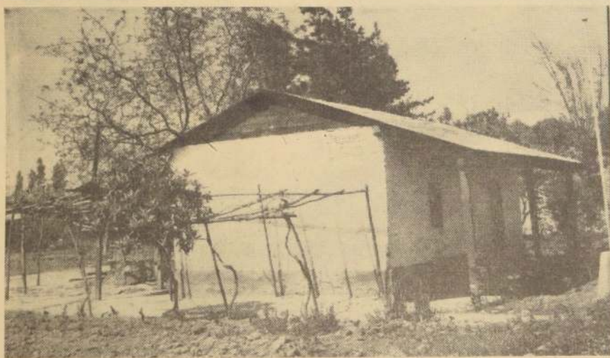
Esta vivienda puede ser mejorada y modernizada gracias a los Planes Habitacionales, en lo que se refiere a Vivienda Campesina. Su construcción es sólida y dispone de techo seguro y metálico, solo le faltan mejores ventanas y más ventilación. Esto es posible gracias a los planes de la CORVI, que además de contemplar recursos para nuevas viviendas permiten reacondicionar aquellas que ofrecen requisitos mínimos de solidez.
