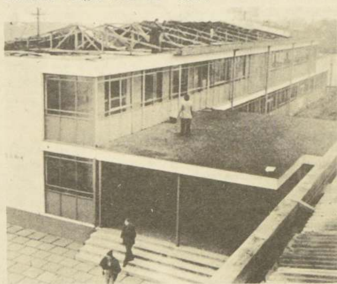
El Liceo Técnico A N° 4 sufrió la voladura de gran parte de su techumbre, a causa del fuerte viento en Valdivia.
