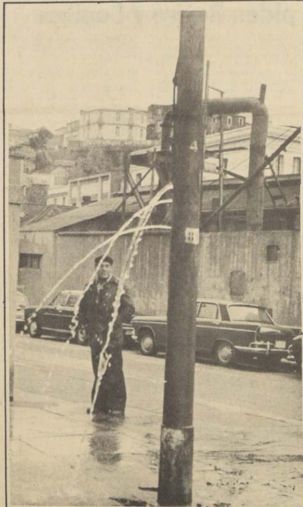
VALPARAISO. — Frente a la "Puerta Valdivia", acceso a los recintos portuarios, en Avenida Errázuriz esquina de San Martín, se presenció este hecho insólito de un poste del alumbrado público convertido en surtidor de agua. Se estimó que una filtración del mar, distante más de medio kilómetro del lugar, emergió por el interior del poste, sin que se registrara un cortocircuito al estar ubicado los orificios más abajo del lugar donde se encuentran los cables de energía eléctrica.
