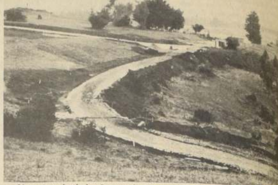
Una vista desde las Lomas de San Andrés, donde se efectúan trabajos de urbanización. Las tres etapas significarán una inversión financiada en forma directa a través de entidades bancarias, equivalentes al valor de cinco torres en pleno centro de Concepción.
