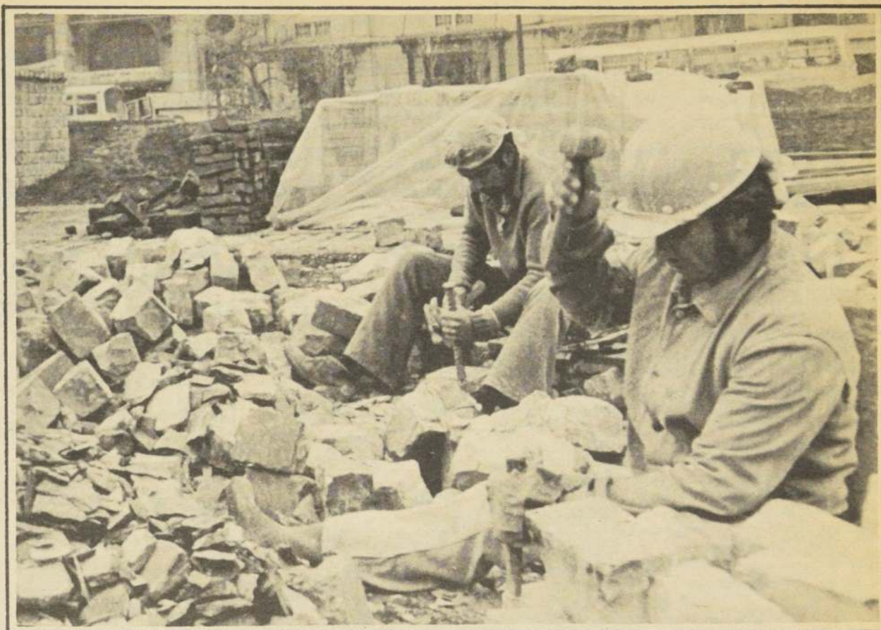
↑ LOS TRABAJADORES independientes también podrán tener sindicatos. Se trata de que se reúna el quórum que la ley establece y sin mayor trámite que redactar estatutos y presentarlos a la Inspección del Trabajo, automáticamente quedará constituida jurídicamente la nueva organización laboral.
